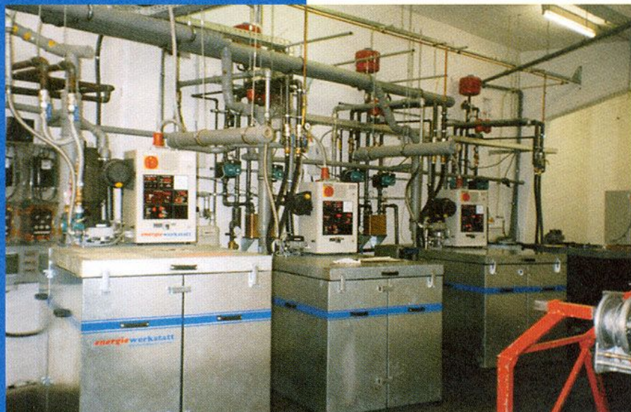
Werksseitiger Probetrieb von 3 BHKW-Modulen im Teststand
