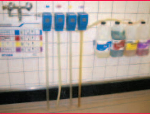
Dosiergeräte: Installation moderner Geräte zur Reinigungsmitteldosierung, durch die der Verbrauch von Reinigungsmitteln gesenkt wird.
