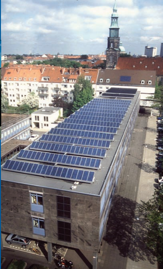
Fotovoltaikanlage auf dem Haus kirchlicher Dienste
