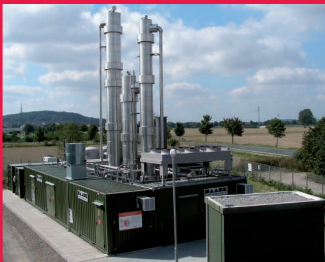
Biogasaufbereitung zu Erdgasqualität in Ronnenberg
